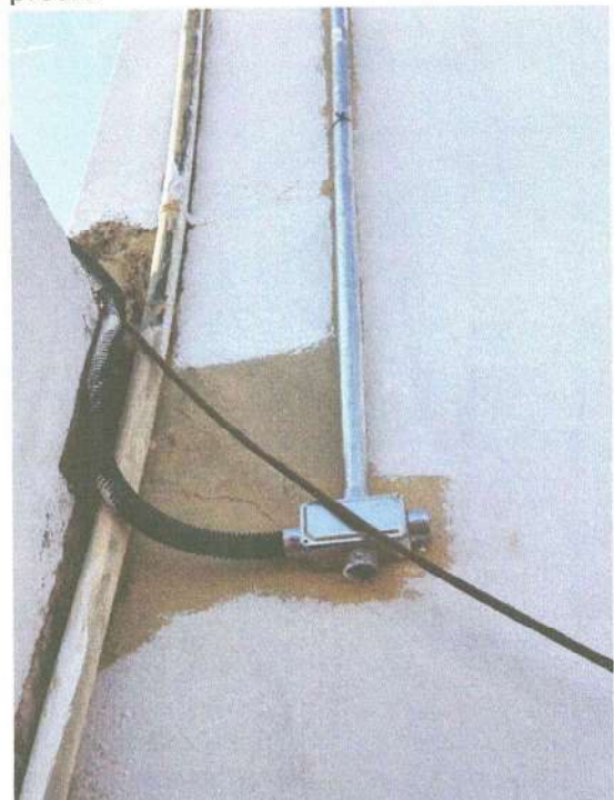
Condute de alumínio para fiação
