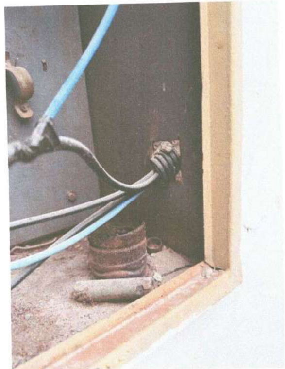
Embutiu cabo que leva a energia para o prédio
