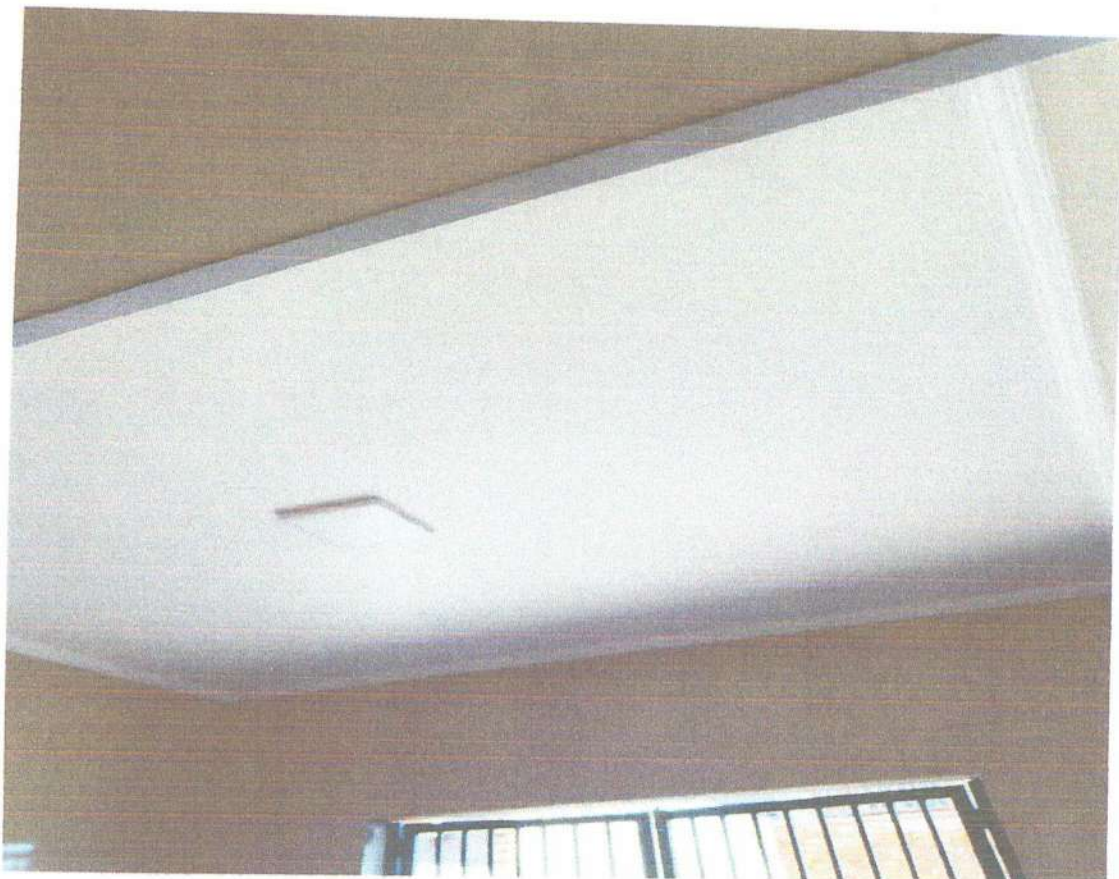
Teto da lavanderia
