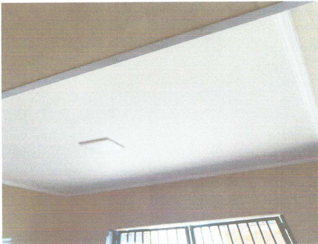
Teto da lavanderia
