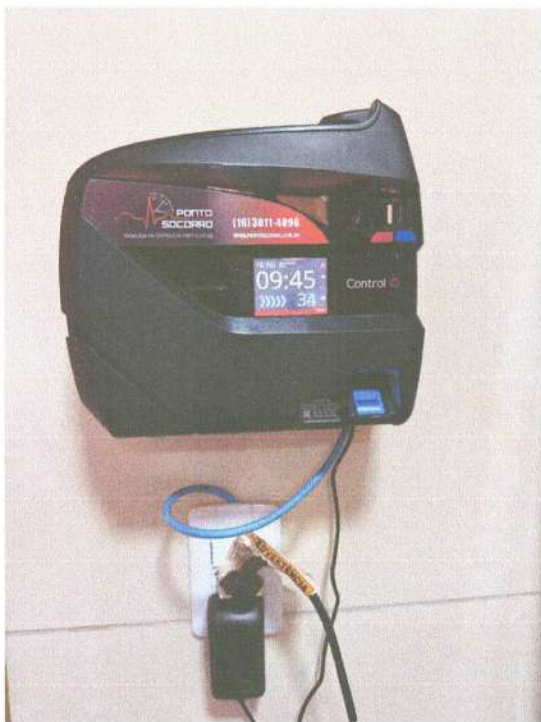
CABEAMENTO CABO DA INTERNET
